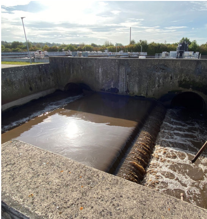
Bild 3: Zuführung von Natriumaluminat Verteilerbauwerk Belebungsbecken
