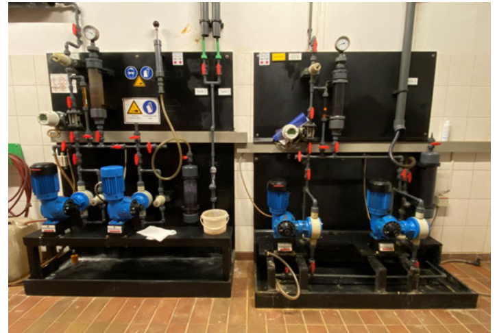
Bild 2: Dosieranlage für Natriumaluminat und Eisen-III-Chlorid mit Dosierpumpen
