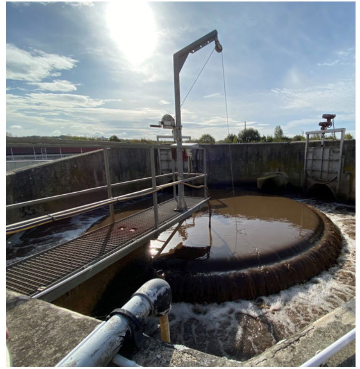
Bild 4: Zuführung von Eisen-III-Chlorid im Verteilerbauwerk Nachklärbecken (Bilder: WAD GmbH)
